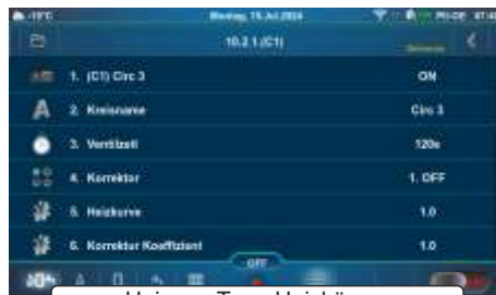
Heizung Typ - Heizkörper
