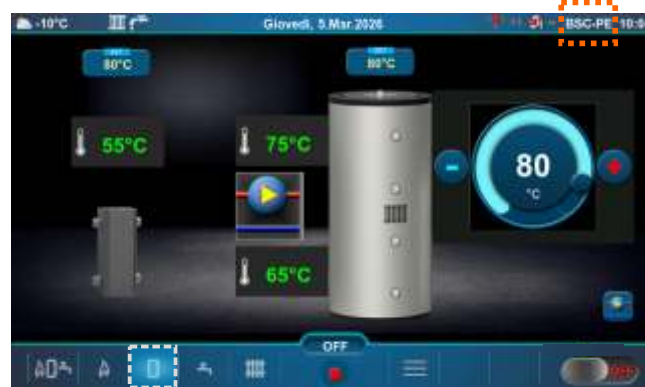
Schermata del serbatoio di accumulo (BSC-PE)
