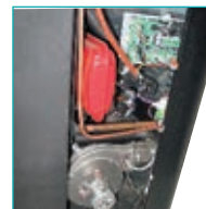
Ekspanzijska posuda, ventilator za odvod dimnih plinova
