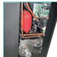
Ekspanzijska posuda, ventilator za odvod dimnih plinova
